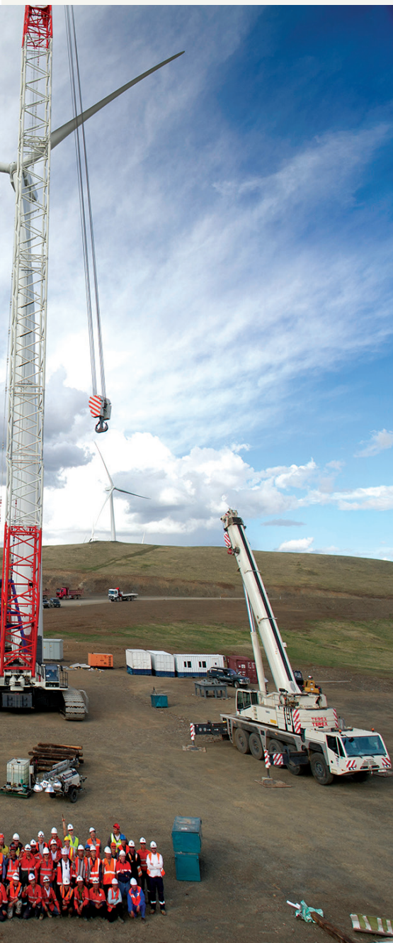
Хамгийн сүүлийн салхин сэнсийг угсарч дууссаны дараа барилга угсралтын ажил гүйцэтгэгч Лейтон ХХК-ын ажилчид
